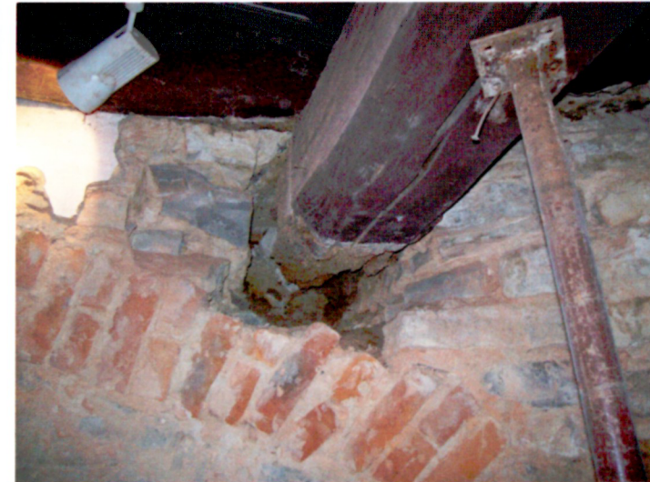
Schadensanalyse der angefaulten Balkenköpfe
