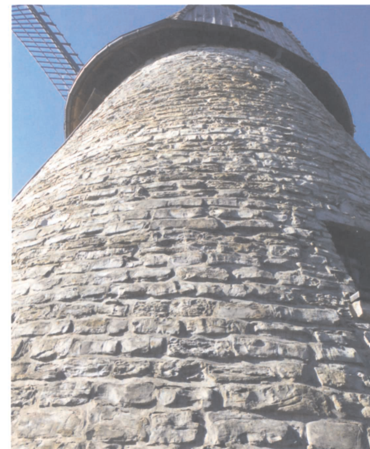
Die Schäden an Mauerwerk und Fugen haben in den letzten Jahren weiter zugenommen
